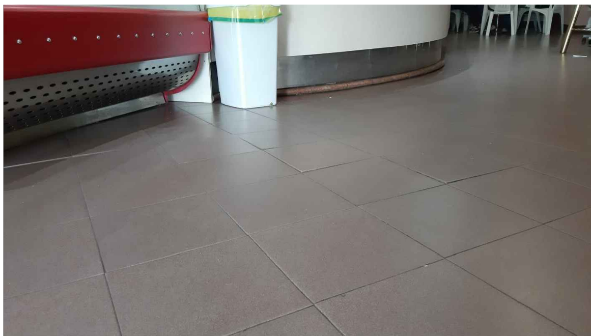
foto 11 - vista del pavimento ammalorato.
