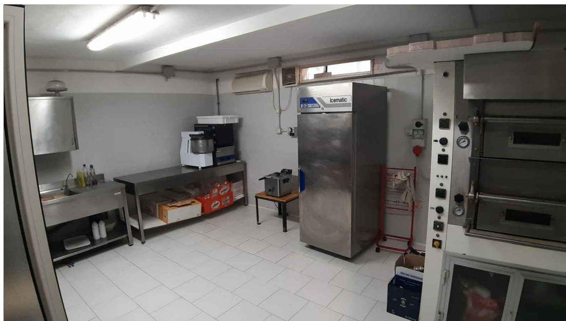
foto 9 - vista della cucina.
